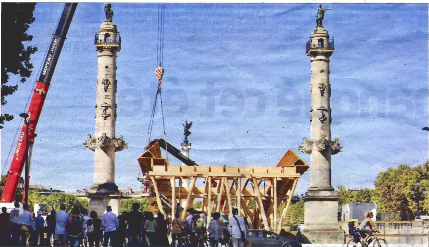
Il y avait déjà du monde pour la mise en place de la passerelle Kawamata dans le cadre d'Evento. PHOTO ALEXANDRE SIOCHAN DE KERSABIEC
