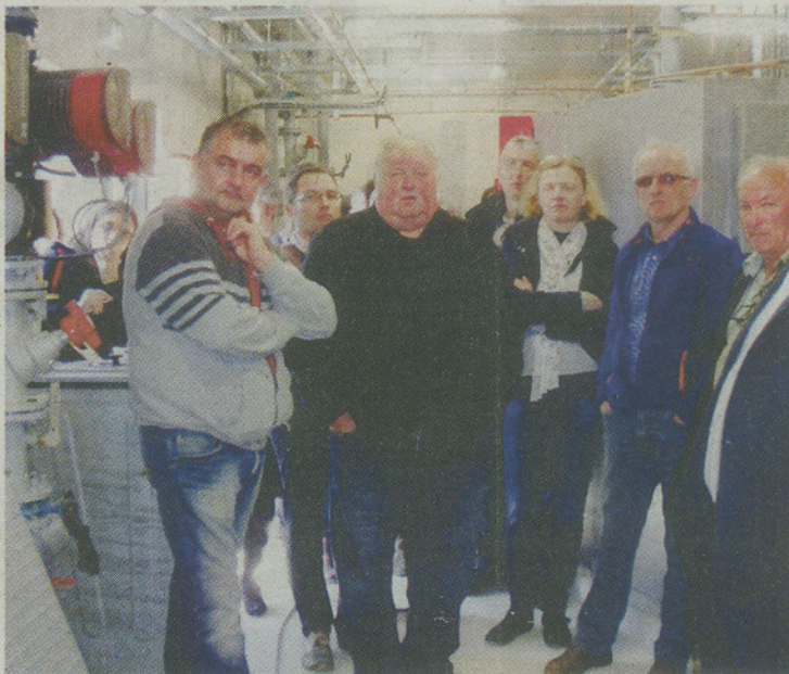
La chaufferie a suscité beaucoup d'intérêt. © MICHÈLE JACOB
