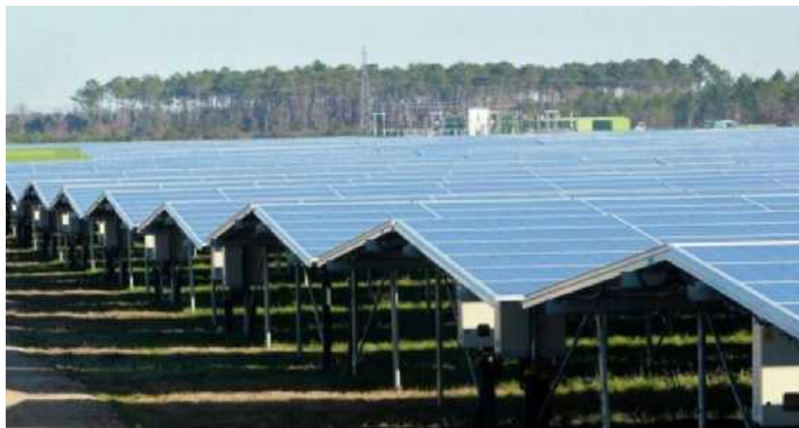
Le parc photovoltaïque de Cestas porté par la société Neoen est le plus vaste de France. Le projet de Saucats est trois fois plus grand. STÉPHANE LARTIGUE / "SUD OUEST"
