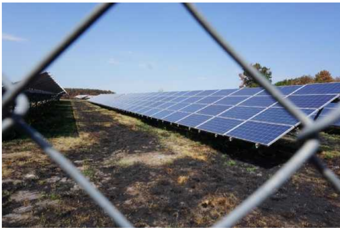
La centrale photovoltaïque d'Hostens a été durement touchée par les incendies. J.J.
